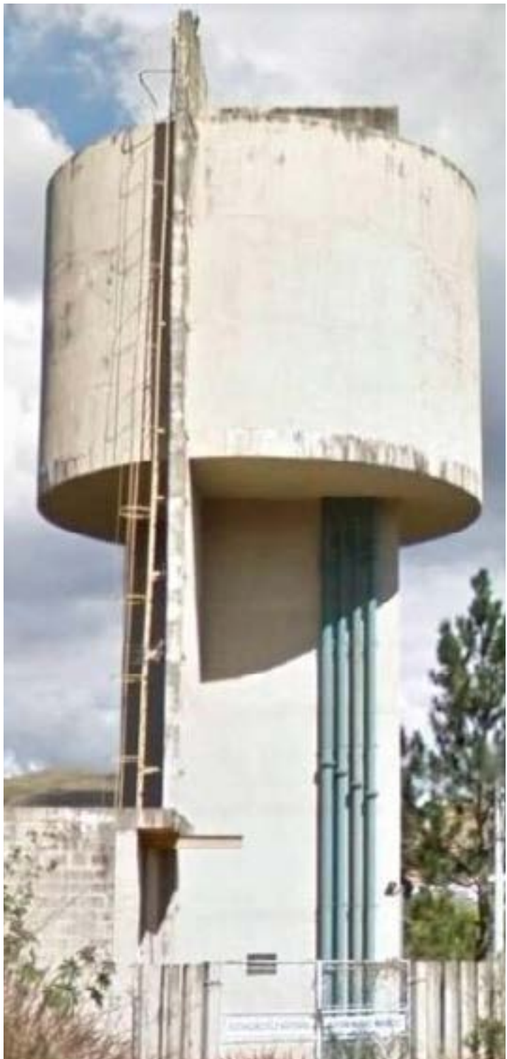
INSTALAÇÕES do DMAE são alvo constante de furtos e vandalismo
